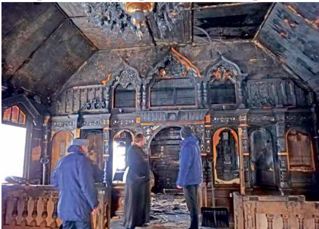
Осматривая повреждения церкви от пожара. Фото: Алар Таса
